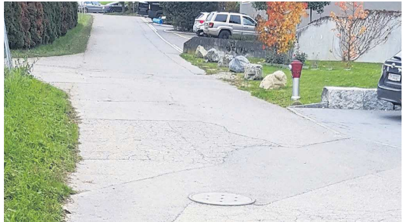
Die Hausmatten-Quartierstrasse weist diverse Schäden auf.
