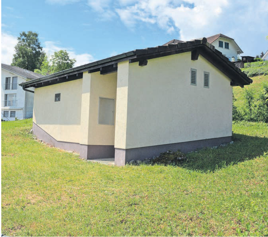
Rund um das Grundwasserpumpwerk Rütimatten sind verschiedene Massnahmen bezüglich der Schutzzone nötig.
