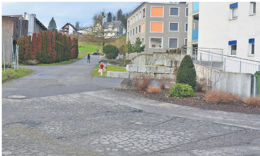
Der Sanierungsbedarf am Belag an der Werdstrasse/Hausmatten ist unbestritten.
